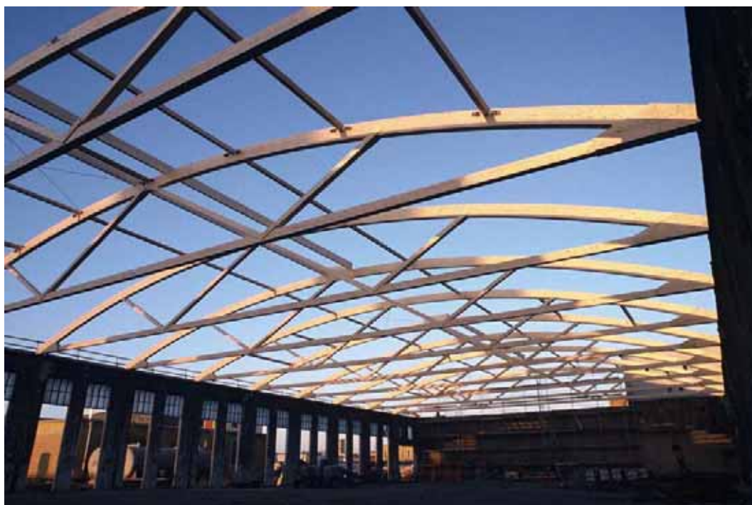
Abb. B3.5 Fachwerkbogenbinder nach System „Freespan“ für die Produktionshalle der Fa. AMAG, Ranshofen/OÖ (Quelle: Fa. WIEHAG)
