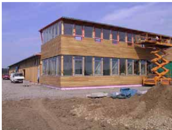
Abb. B1.3 Impulszentrum Bad Radkersburg: Arch. DI N. Frei, Hausmannstätten. Holzbau: Stingl Holzleimbau, Trofaiach. „Hallenschachtel“ aus Wand- und Dachscheiben mit Pi-Elementen als Schubfelder (Quelle: H. Stingl)
