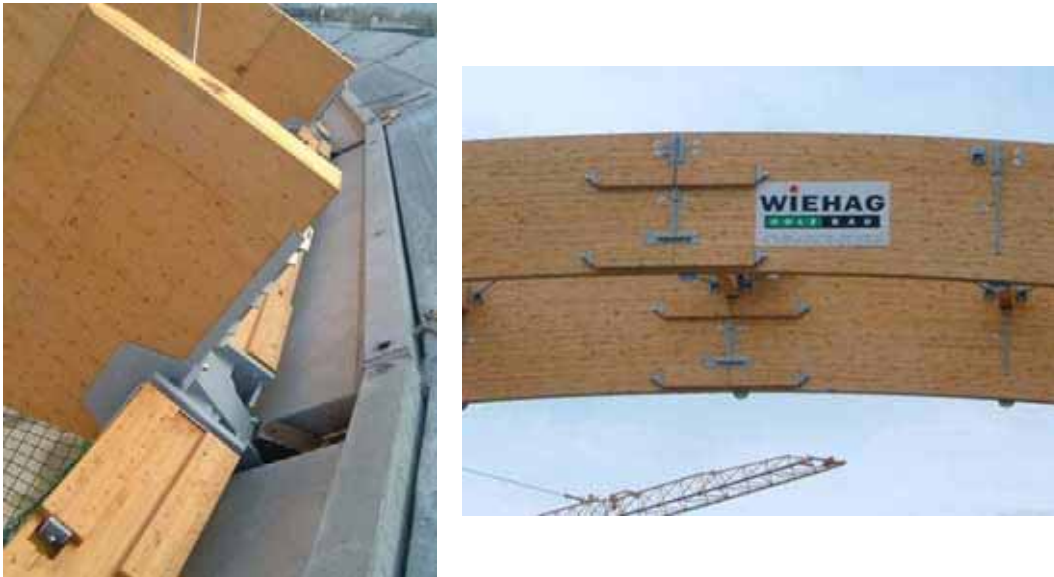
Abb. B2.14 Ringträger an den vorgegebenen Auflagerkonturen (links), Firstknoten (rechts) (Foto: WIEHAG)
