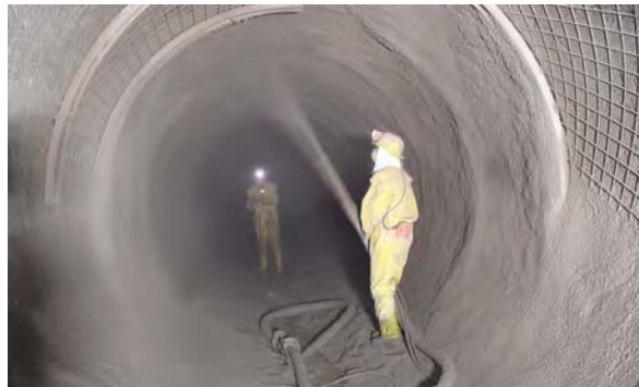
Abbildung 2.15: Auskleidung von erosionsgefährdeten Abschnitten des Druckstollens für das KW Kartell mit bewehrtem Spritzbeton 46
