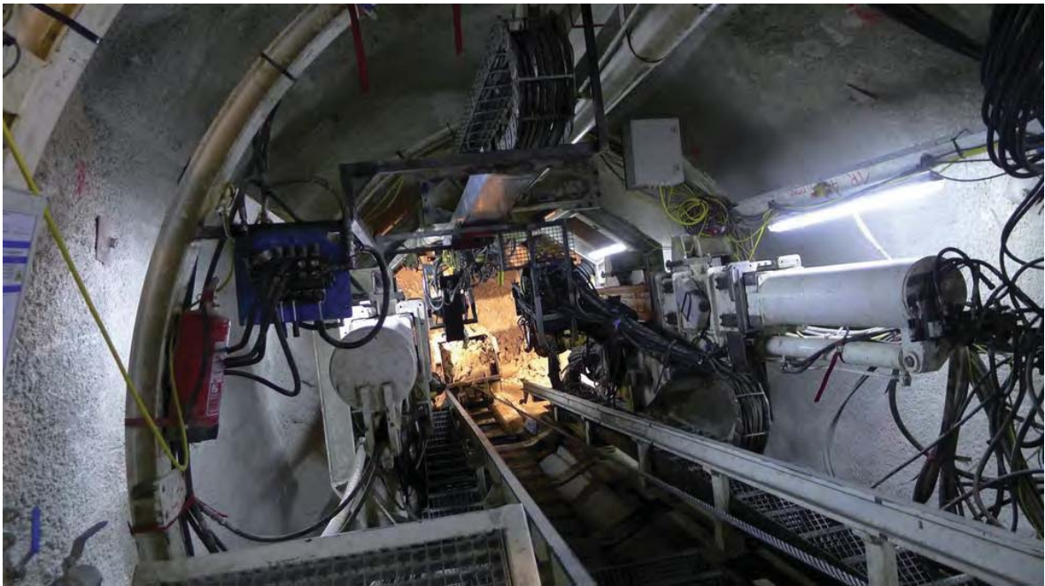
Abbildung 3.38: Schachtabteufeinheit zum Abteufen des 42 Grad geneigten Druckschachtes des PSW Reisseck II - in Bildmitte ist die in Schienen geführte Schutterlore zu sehen 51
