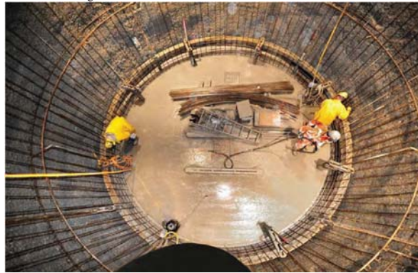
Abbildung 4.14: Herstellung der bewehrten Ortbetonauskleidung mit einer Gleitschalung in den Druckschächten des PSW Nant de Drance 26
