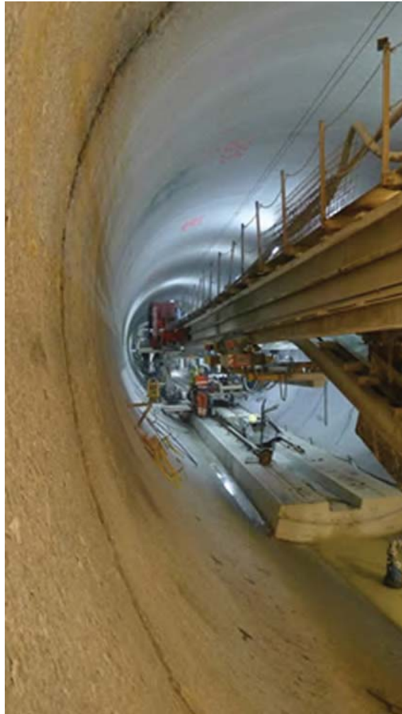
Abbildung 2.19: Beim Vortrieb des Druckstollens für das PSW Reisseck II mit einer Gripper - TBM versetzte Sohlübbinge 56
