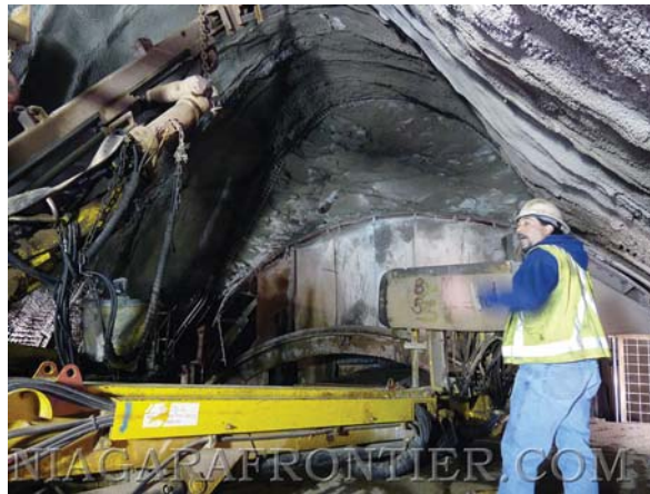
Abbildung 1.7: Niagara Tunnel Project (NTP) Mehrausbruch Firste durch spannungsbedingtes Versagen hinter dem TBM Kopf 13
