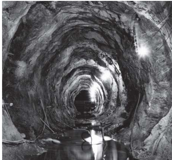
Abbildung 3.11: Sägezahnartiges Überprofil beim Sprengvortrieb der Triebwasserführung zwischen Kenney Dam und Kemano Power Station in British Columbia (Kanada) 14
