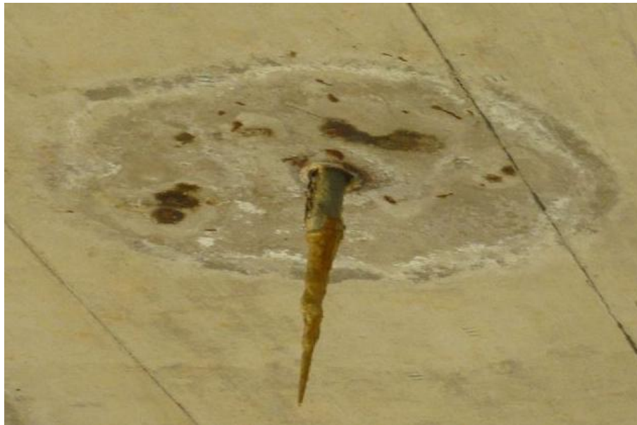
Bild 2.47 Durch Sinter verlegte Abdichtungsentwässerung und Umläufigkeit (S6 Brücke Sonnleiten, RFB St. Michael, 15.07.2008) [37]
