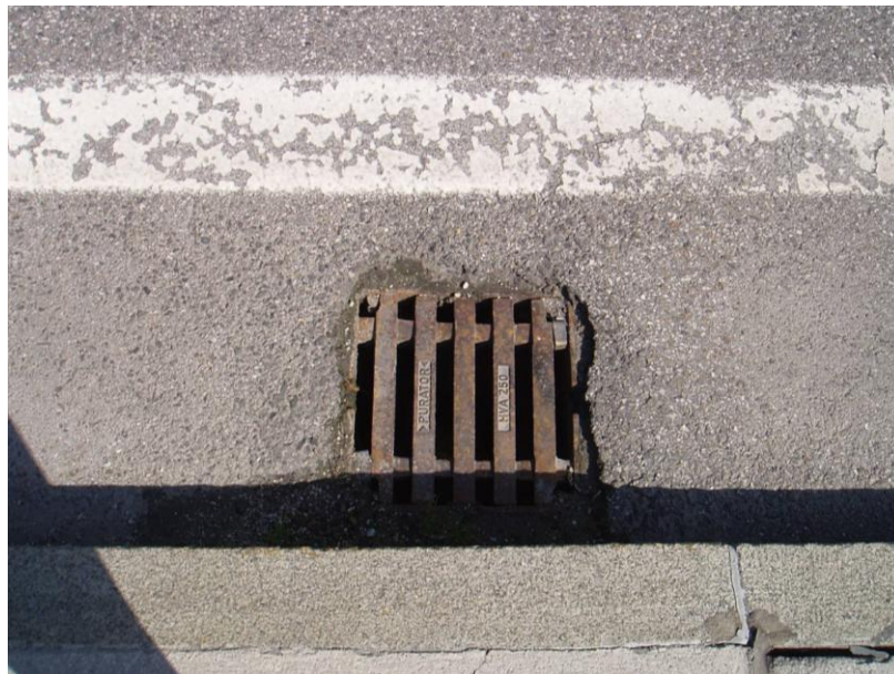
Bild 2.36 Eingebauter Purator Brückeneinlauf (Seewigtalbrücke, 24.05.2007) [37]
