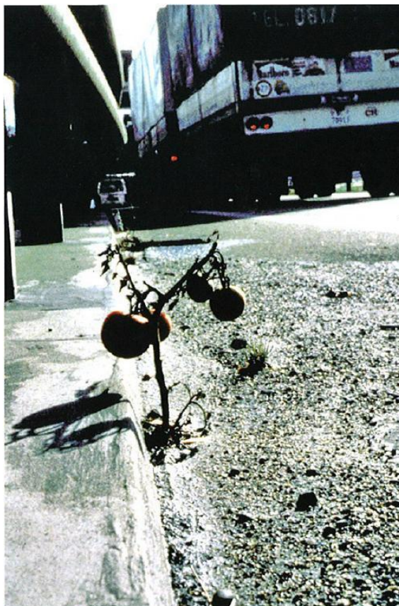
Bild 2.50 Verstopfter Ablauf einer Brückenentwässerung, Abb. 2 in [17 S. 23]
