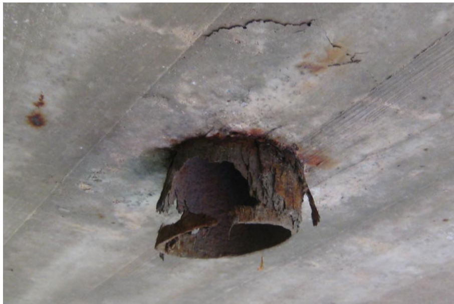
Bild 2.43 Stark korrodierter Entwässerungsablauf [48]
