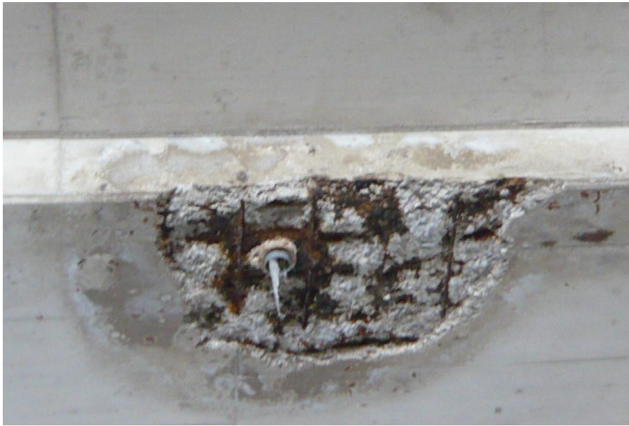
Bild 2.40 Korrodierte Bewehrung durch Umläufigkeit (Brücke Zöbern, 08.02.2010) [37]
