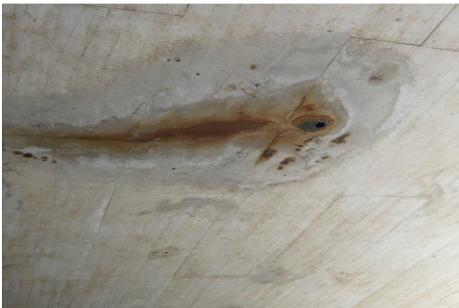
Bild 2.42 Fehlender Ablaufstutzen und Rostfahne am Tragwerk (S36 Unterführung Stadtwaldgasse, 25.06.2007) [37]
