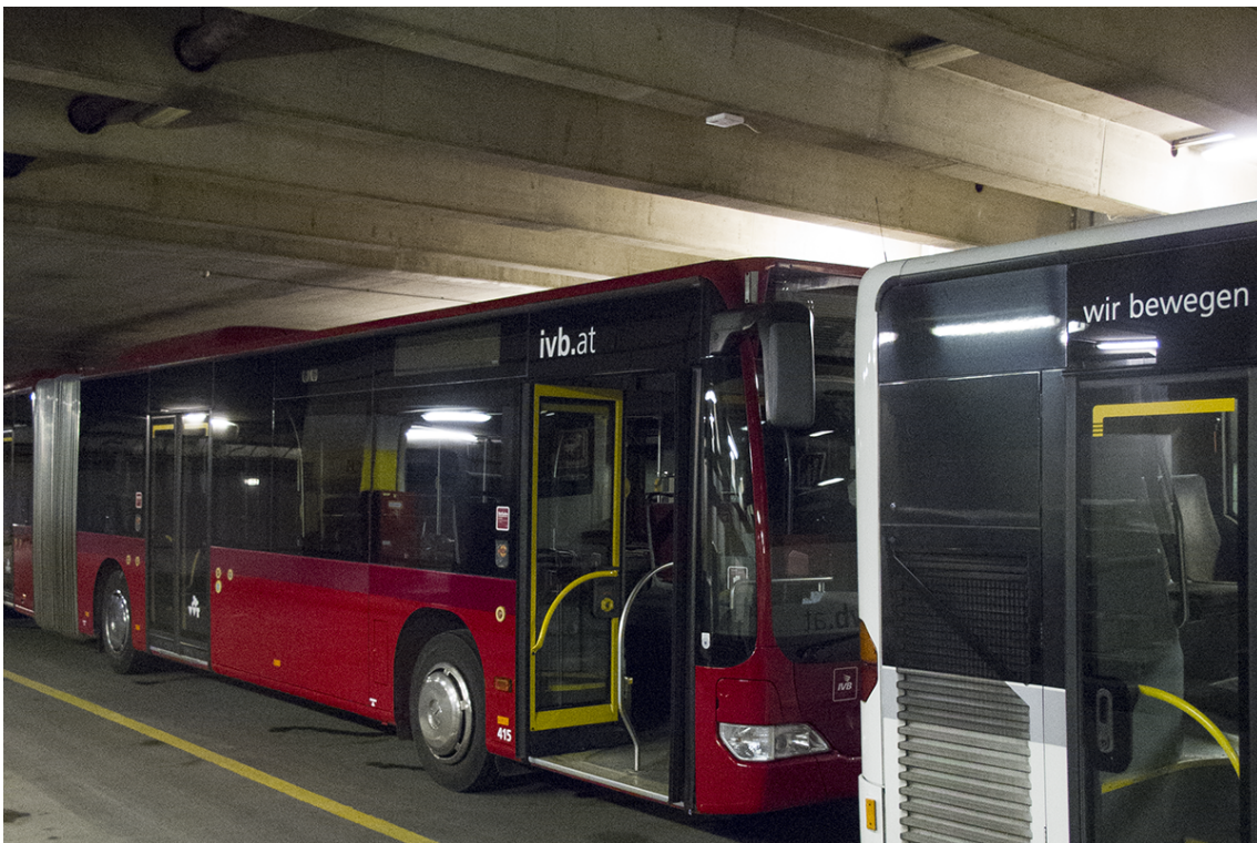
Abbildung 4.11: Geparkter Gelenkbus in Halle 1 mit Access Point AP-51-68 an der Decke.
