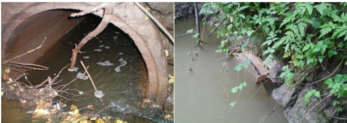
Abb. II-21: Mündungsbauwerk des Oberdorfer Baches – verklaustes Rohr oberwasserseitig (links) und bereits bei Mittelwasserführung eingestaute Klappe unterwasserseitig (rechts) [Foto Sulzbacher, Juli 2009]
