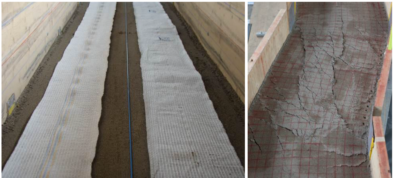
(a) Installierte faseroptische Sensoren
