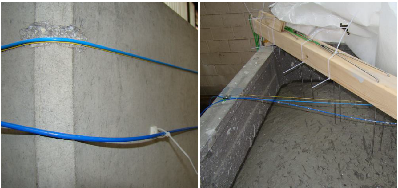
(a) Sensorkabel, Außenseite
