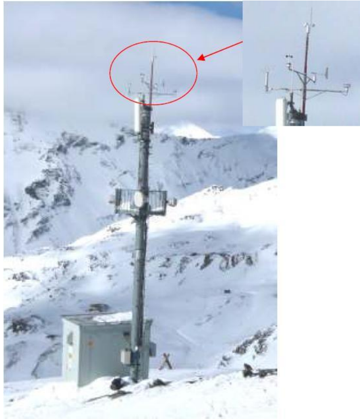
Abbildung 31: Messstation Großglockner mit installierter Sensorik (Lachinger, 2011)
