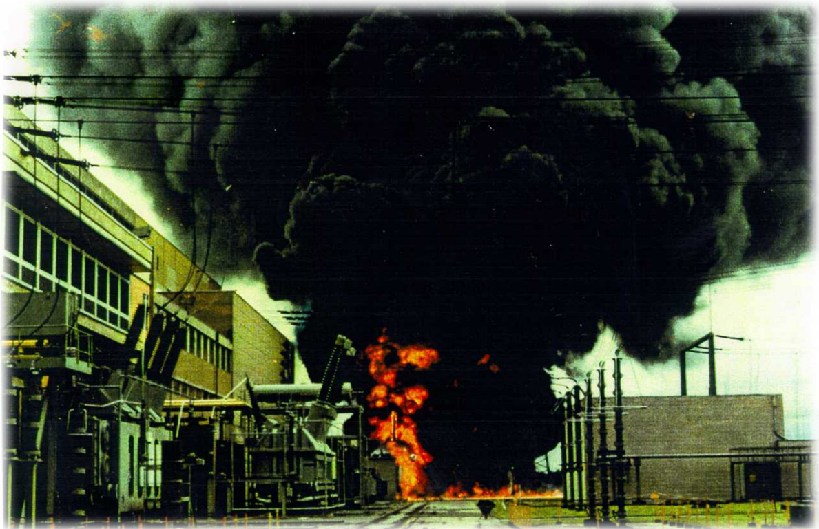
Abbildung 1-4: Transformatorbrand aufgrund einer defekten 380kV Durchführung im KW Frimmersdorf (Deutschland) [5]
