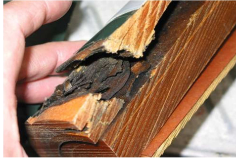
Abbildung 2-17: Zerstörte RBP Durchführung [17]
