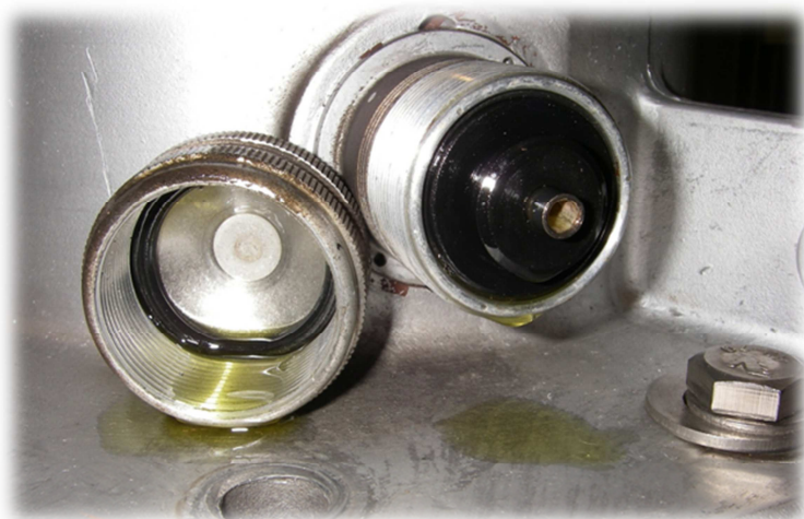
Abbildung 8-17: Feuchter Messanschluss der RBP6 Durchführung [eigenes Foto]
