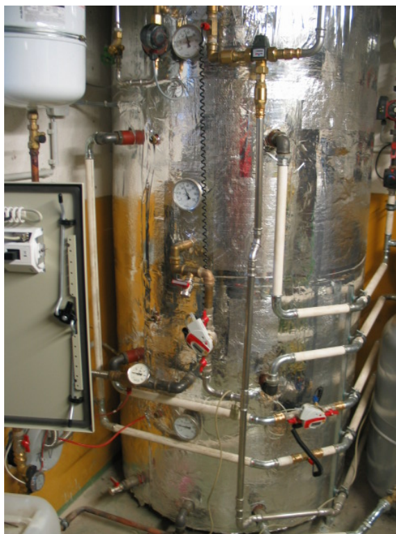
Abbildung 47: Rohrleitungen Anlage B
