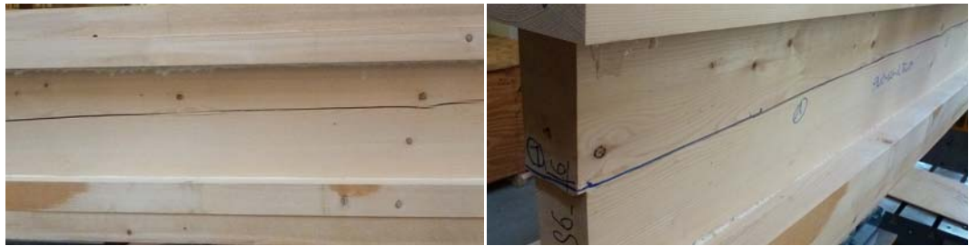
Abb. 4.8 Vorschädigung und Bruch des Trägers T6_04 (Trockenrisse)
