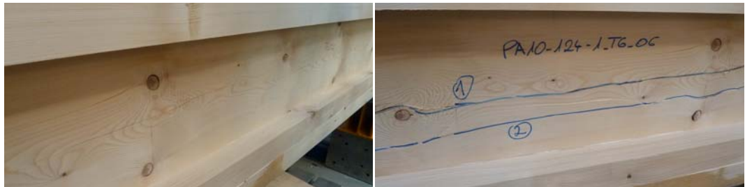
Abb. 4.9 Vorschädigung und Bruch des Trägers T6_06 (Trockenrisse)
