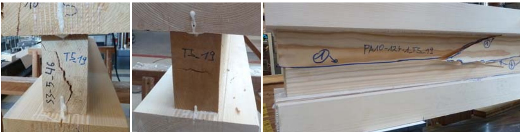
Abb. 4.7 Vorschädigung und Bruch des Trägers T5_19 (Trockenrisse)
