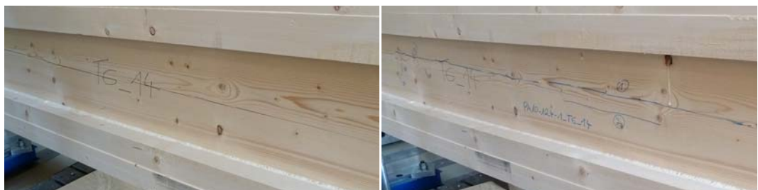
Abb. 4.12 Vorschädigung und Bruch des Trägers T6_14 (Trockenrisse)
