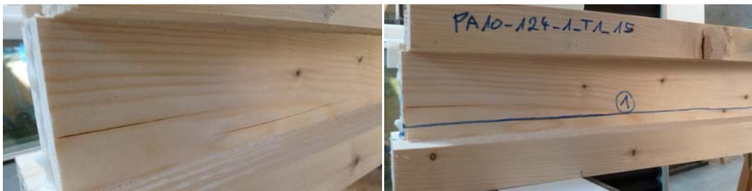
Abb. 4.1 Vorschädigung und Bruch des Trägers T1_15 (Trockenrisse)
