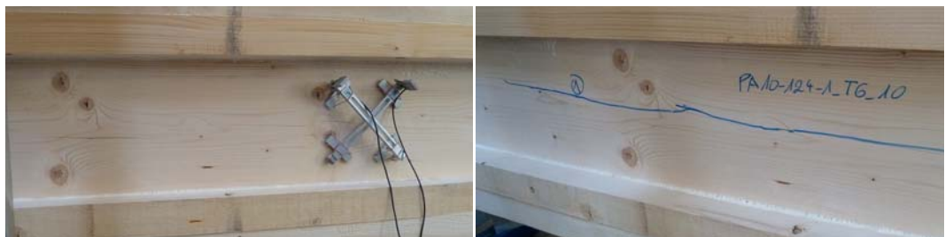
Abb. 4.10 Vorschädigung und Bruch des Trägers T6_10 (Trockenrisse)
