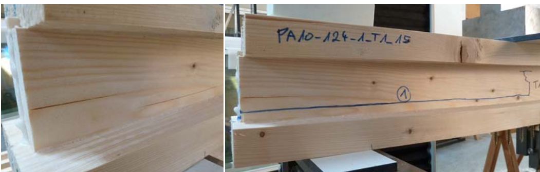
Abb. 3.3 Versagen des Trägers T1_15 aufgrund von Vorschädigung S_VS (Trockenrisse)
