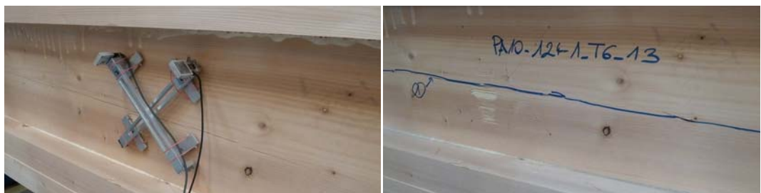
Abb. 4.11 Vorschädigung und Bruch des Trägers T6_13 (Trockenrisse)
