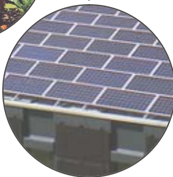
Photovoltaikanlagen auf den Dächern der horizontalen Gebäudetypen
