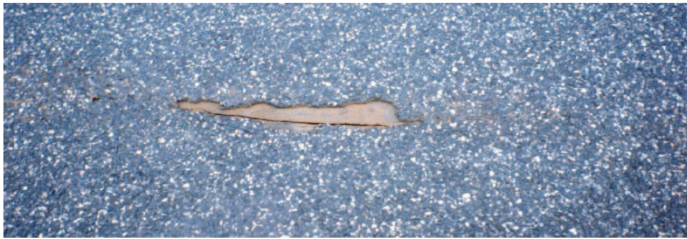
Abbildung 5.3: Sich im dünnen Epoxidharzbelag abzeichnender Deckblechriss, [1]
