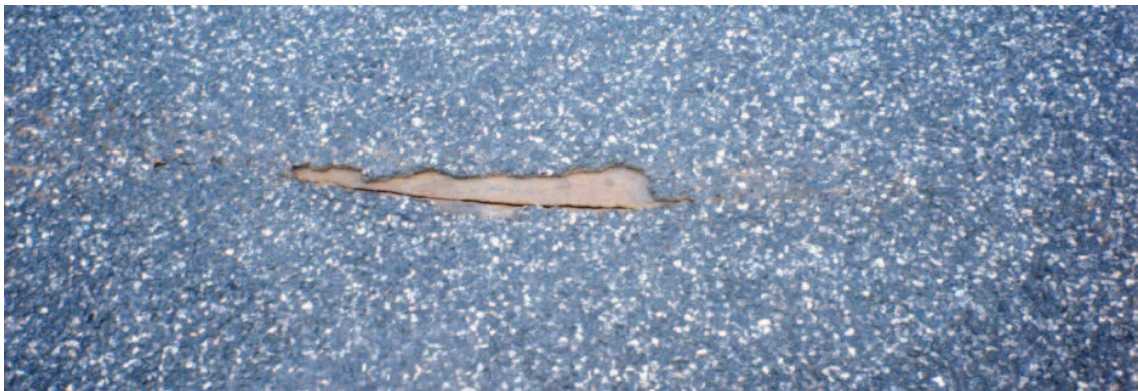
Abbildung 1.1: Sichtbarer Riss im Dünnbettbelag und dem darunter liegenden Deckblech[1]
