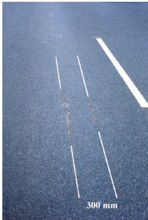
Abbildung 5.2: Parallellrisse an derselben Längssteife die sich an der Belagsoberseite abzeichnen, [1]
