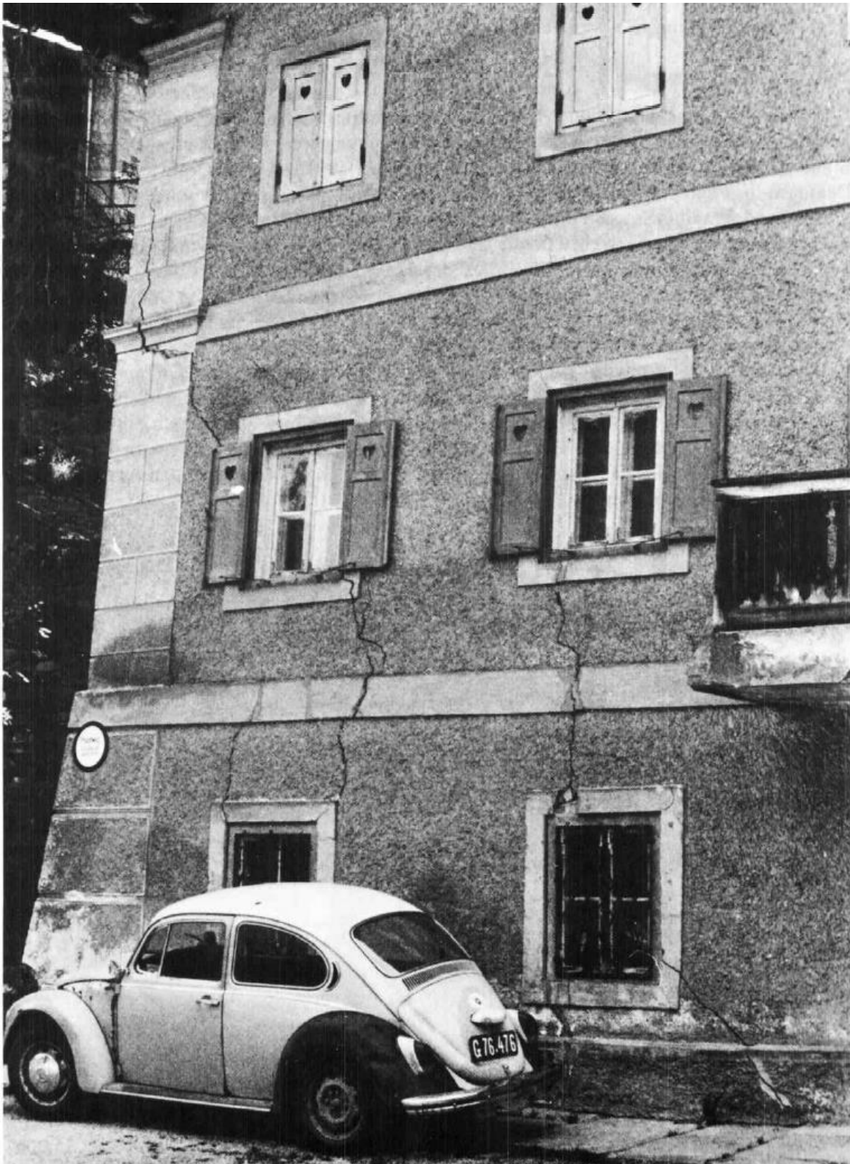
Abbildung 67 Risse im Mauerwerk des Grabenwirt in den 1970er (befand sich nordwestlich unterhalb des Gasteinerhofs) (Scheidegger und Hauswirth 1980)
