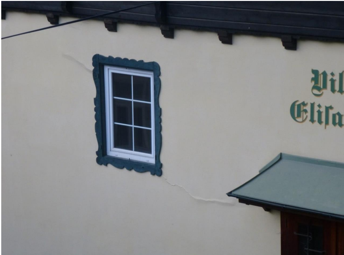
Abbildung 69 Risse sichtbar in der kürzlich neu gestrichenen Fassade der Villa Elisabeth (unmittelbar talseitig der Hangbrücke Gravenegg) (2012)
