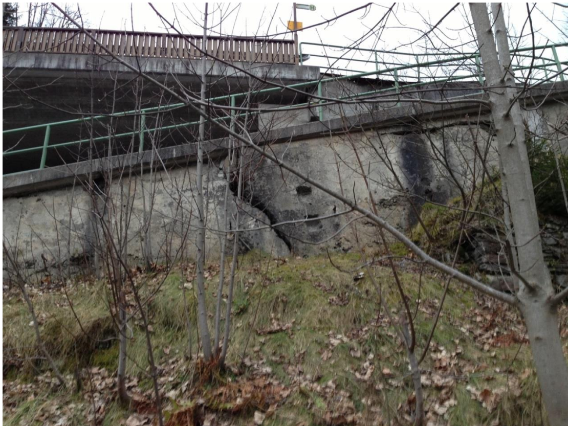
Abbildung 70 Risse im Mauerwerk der Wasserfallstraße (direkt unterhalb des südlichen Widerlagers der Hangbrücke Gravenegg) (2012)
