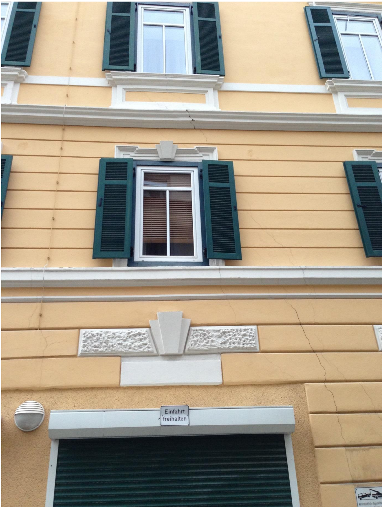
Abbildung 68 Risse durchziehen gesamte Fassade (Nachbargebäude nordwestlich der Pfarrkirche) (2012)
