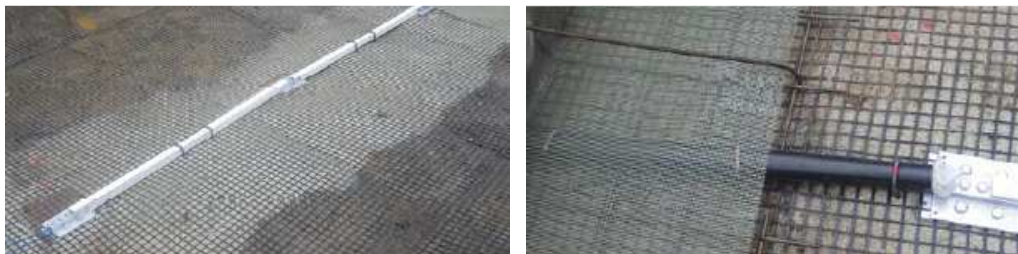
Abbildung 23: links: Kabelkanal zum Schutz für die optische Faser; Schutz der Faser im vorderen Bereich (Dammaußenseite)
