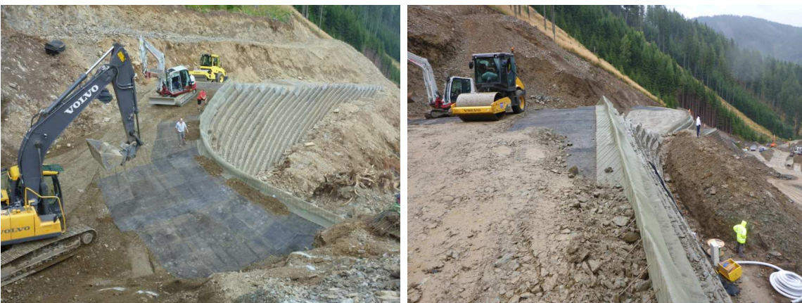
Abbildung 10: Stufenförmiger Aufbau einer Lage nach Schüttung und Verdichten des Dammmaterials (Deponie Longsgraben)
