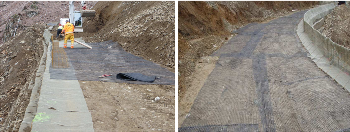
Abbildung 9: Verlegung der Geo- und Bewehrungsgitter sowie des Vlieses in der Deponie Longsgraben
