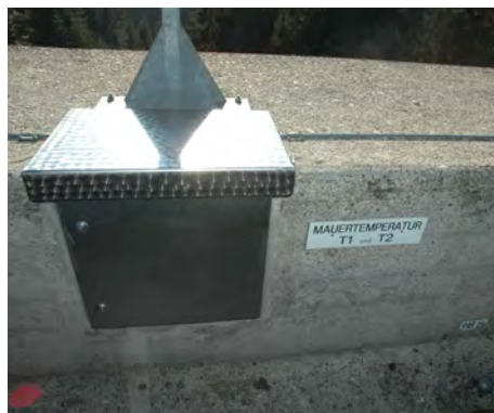
Abb. 3.7: Elektr. Anschlusskasten der Temperaturlaufnehmer
