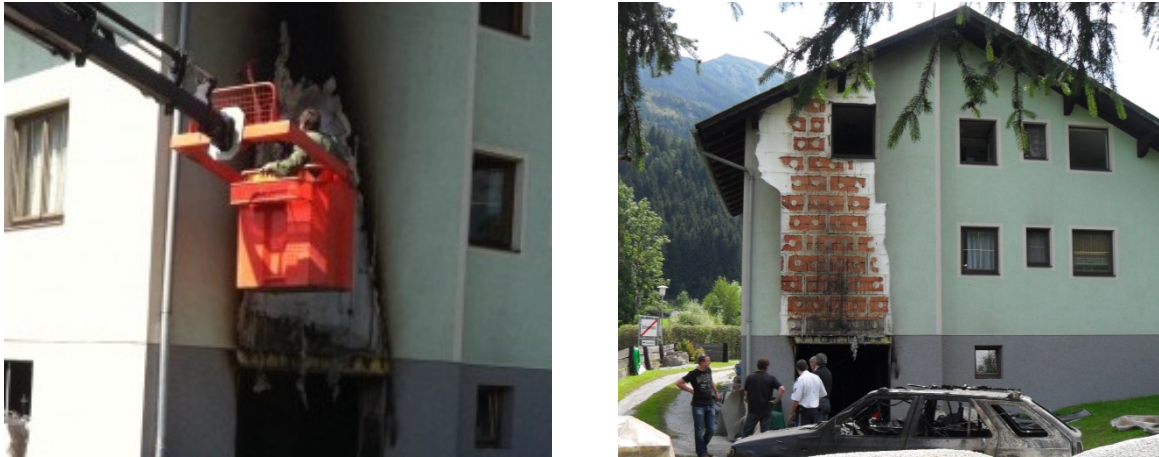
Abb. 2-14: Brandfall St. Georgen (Österreich) 2011 – Fassadenschädigung [42]
