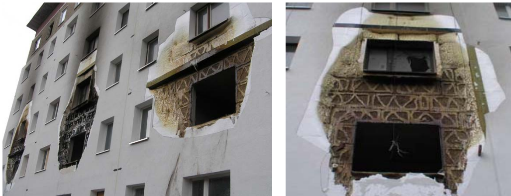
Abb. 2–19: Schädigung Dämmebene nach Entfernen der Putzreste [99, S36]
