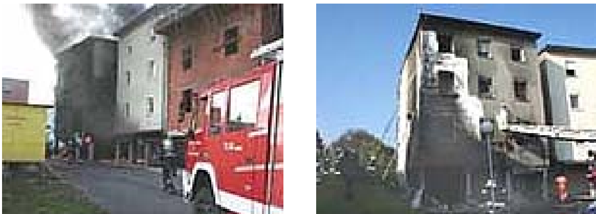
Abb. 2–7: Brandfall Güssing (Österreich) 2007 [36]
