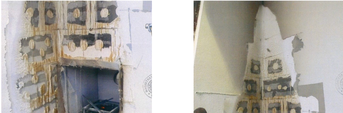
Abb. 4–26: Brandprüfung Armierungswinkel am Sturz – Fassadenschädigung [82]
