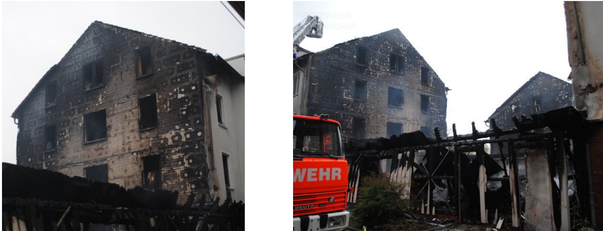
Abb. 2-12: Brandfall Delmenhorst (Deutschland) 2011 – Fassadenschädigung [41]
