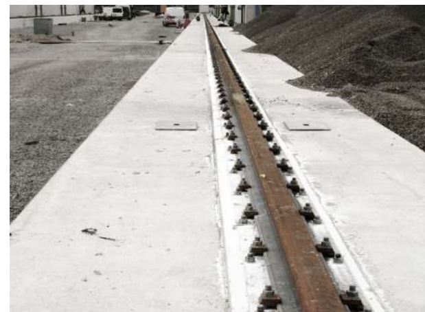
Abbildung 114: (oben) Up-Stop, Schutzsystem einer Achterbahn Abbildung 115: Fahrschiene eines Portalkrans
