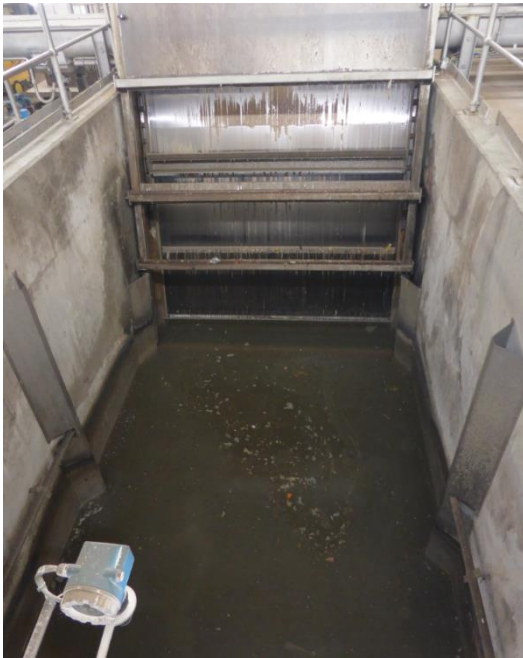
Abbildung 3-4: Umlaufrechen mit Höhenstandsmessung der ARA Graz vor einem der beiden Umlaufrechen
