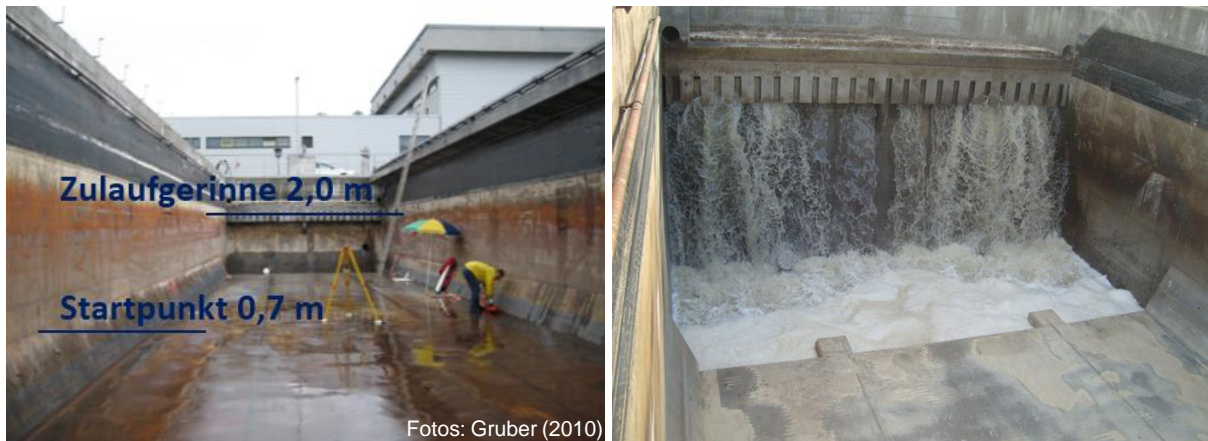
Abbildung 3-8: Geodätische Aufnahme der Geometrie der Vorklärbecken der ARA Graz (links) und Einlauf über das Verteilbauwerk in ein leeres Vorklärbecken (rechts)
