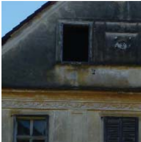
Verfärbungen am Westgiebel des Wohnhauses
