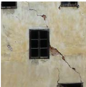
Risse an der Südfassade des Mühlengebäudes
