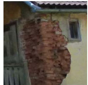
schadhafte Mauerecke des Wohnhauses
