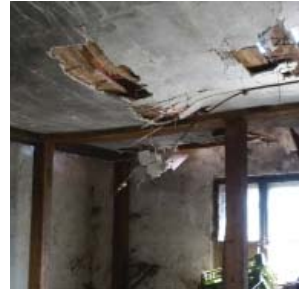
Stark einsturzgefährdete Decke im Waschhaus
