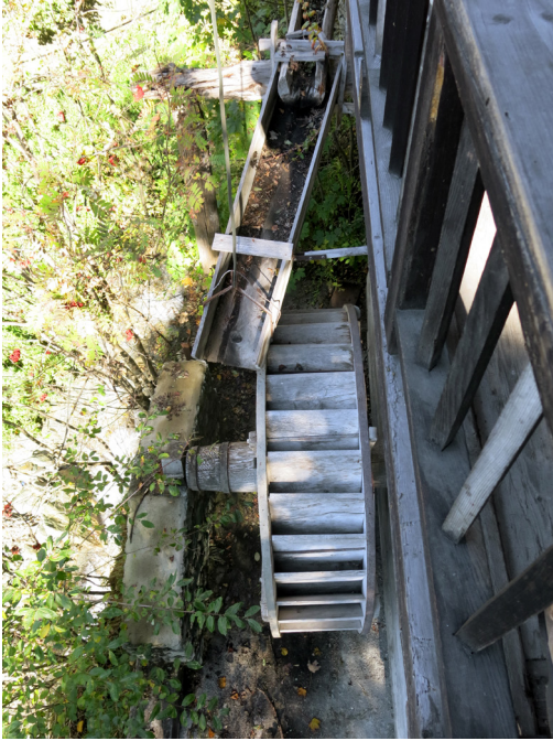
Abb. 52: Einlaufschütz, eigene Aufnahme, 2013
