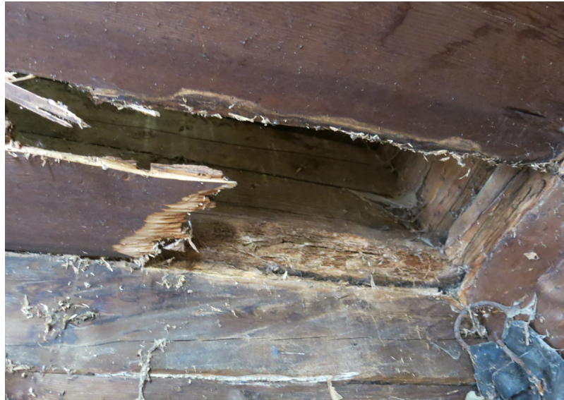
Abb. 68: Beschädigung der Decke im Obergeschoss, eigene Aufnahme, 2013
