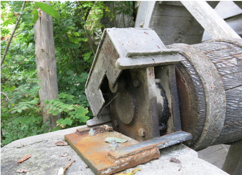
Abb. 72: Rostbildung am Wellenlager, eigene Aufnahme, 2013
