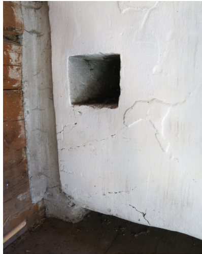
Abb. 61: (links) Kaminöffnung Außen, eigene Aufnahme, 2013
