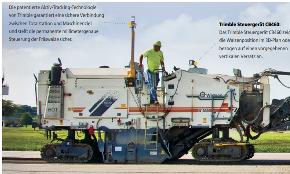
Abbildung 11 Steuerungsausstattung (Trimble PCS900)
