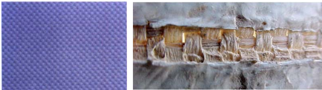
Abb. 2.11 links: PVC-beschichtetes Polyestergewebe [17], rechts: freigelegtes Polyestergewebe durch Beschichtungsablösung [22]
