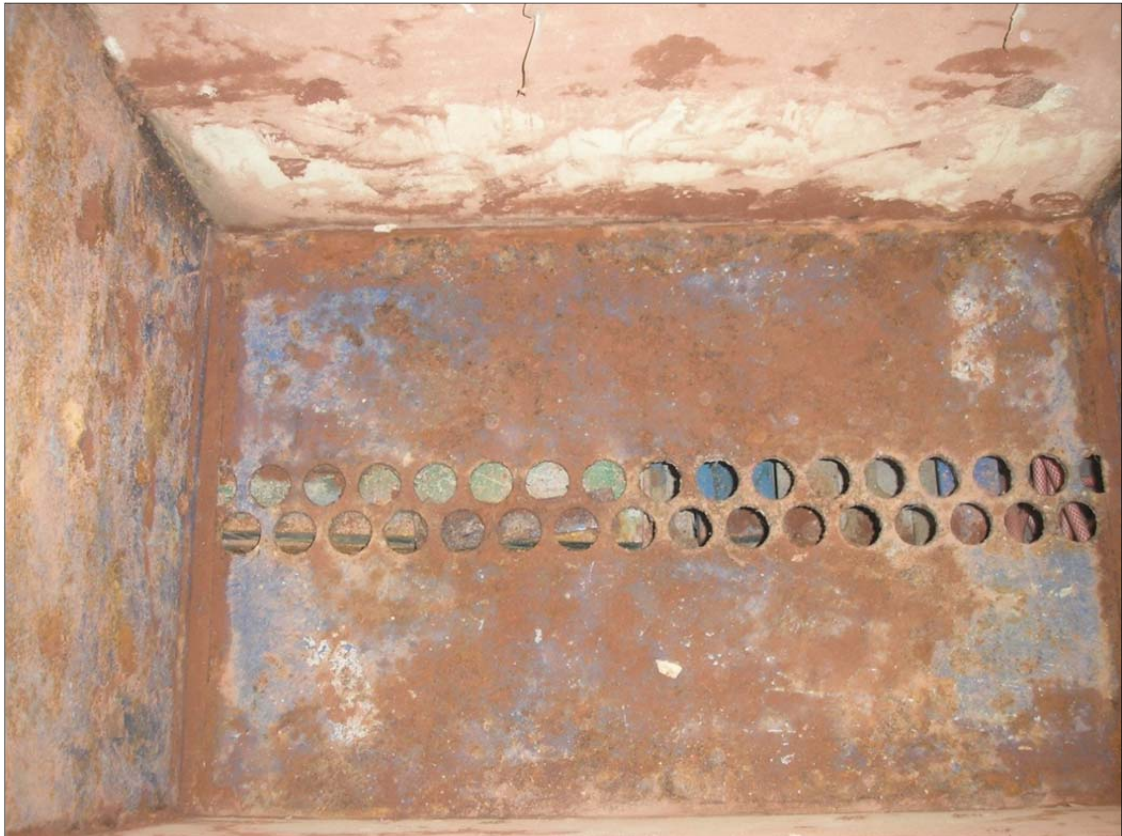
Abb. 30: Sickerwasserkanäle im Stahlbehälter
