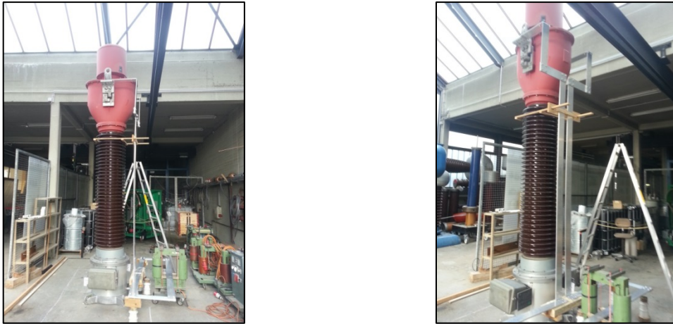
Abbildung 6-8: Aufbau der Stromzufuhr für 1575 A
