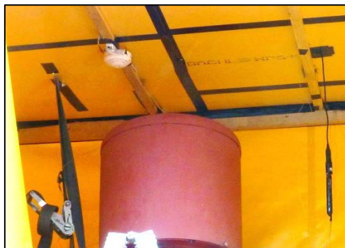
Abbildung 6-15: Feuermelder über dem Prüfobjekt
