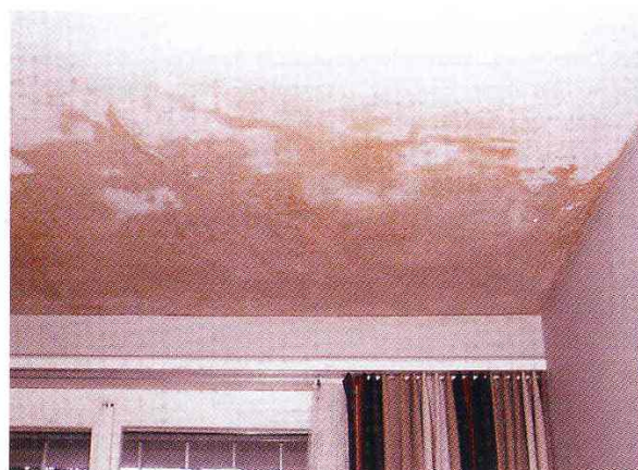
Abbildung 4.6: Feuchteschäden an einer Decke [6]
