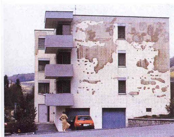
Abbildung 4.5: Abspelungen eines Außenputzes [6]
