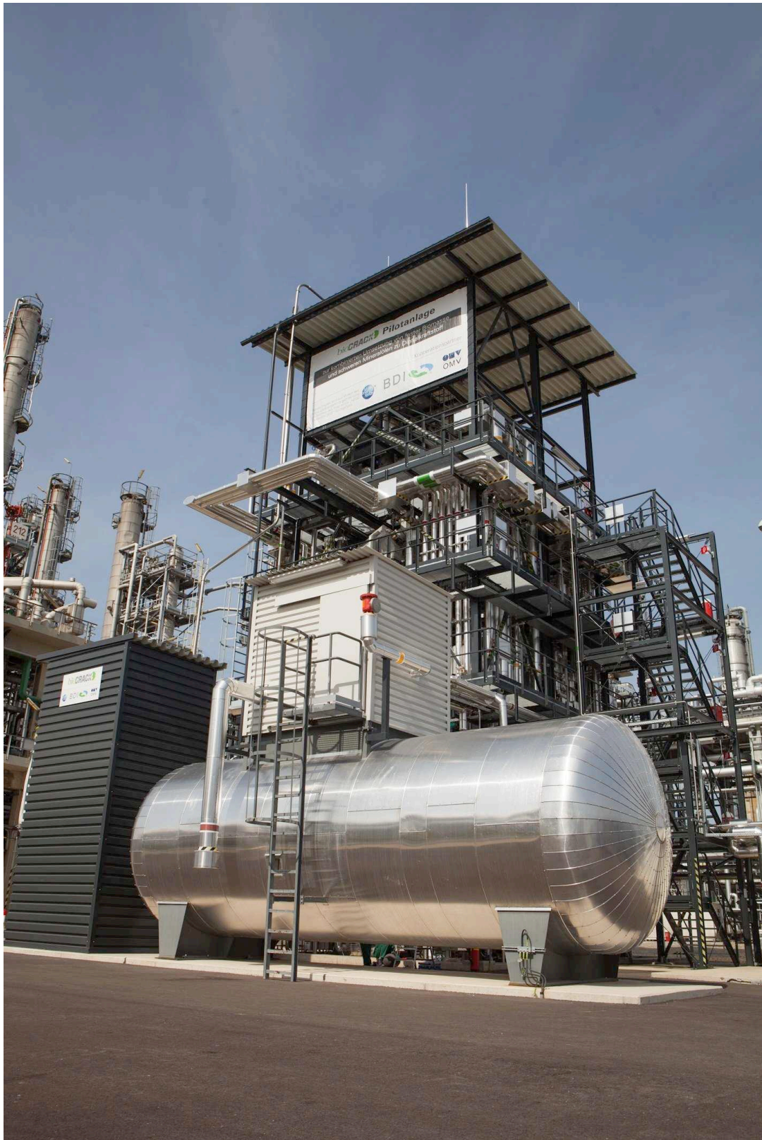
Abbildung 1.1.: bioCRACK Pilotanlage Schwechat – Quelle: APA-OTS [2]
