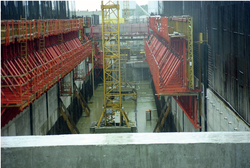
Abbildung 4.2: Blick in den Grundlaufkanal aus südlicher Richtung: Der Wasserstand im Grundlaufkanal beträgt ca. 30 cm. [NBA-Hannover, 2002a]
