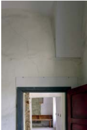
307 TÜR 1.5.4.1, DEUTLICHER RISS DARÜBER
