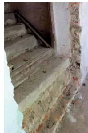
315 ERSTEN STUFEN FEHLEN, TÜRRAHMEN SICHTBAR, EHEM. VERMAUERUNG WURDE ENTFERNT
