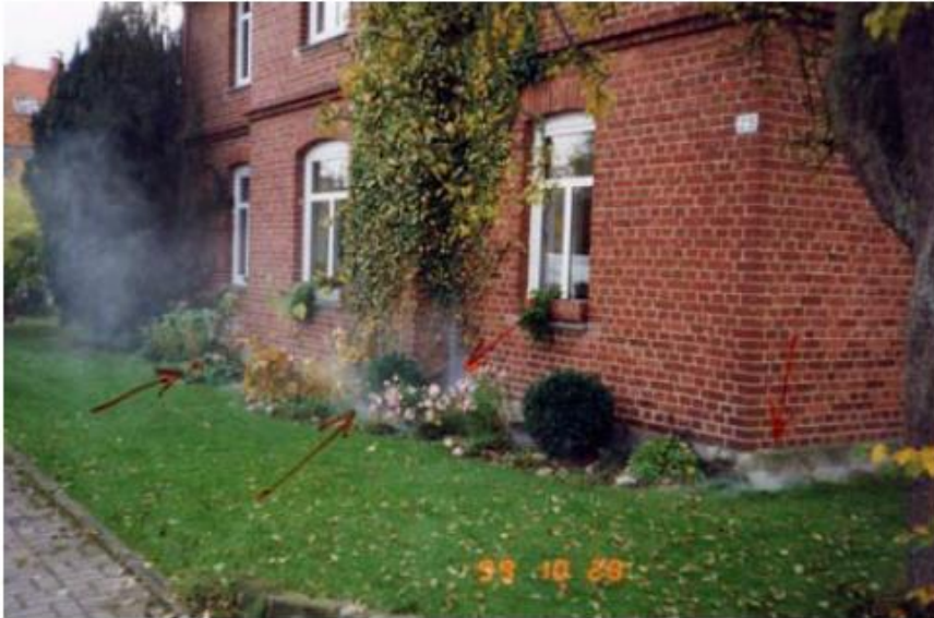
Abbildung 31: Rauchaustritt bei Hausdränage (Scaria, 2002)
