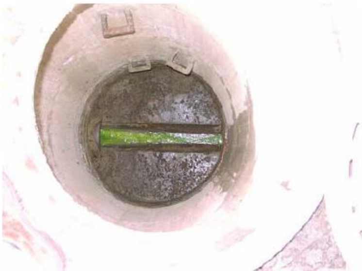
Abbildung 32: Beweis eines Fehlanchlusses eines Einlaufes durch eine Farbtraceruntersuchung (Scaria, 2002)
