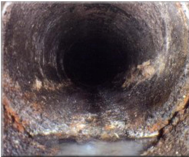
Abbildung 2: Durch Chemikalien beschädigtes Rohr (Environment Consult in Scaria, 2002)
