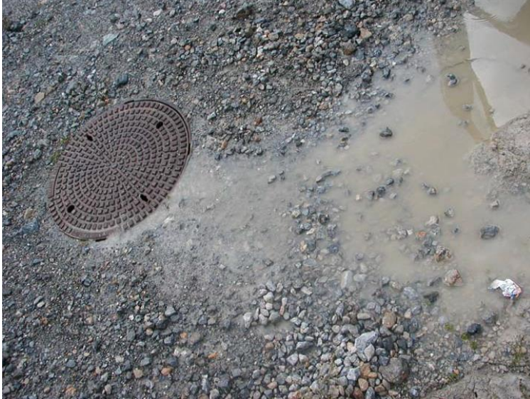
Abbildung 14: Fremdwassereintritt über die Schachtabdeckung (Scaria, 2002)
