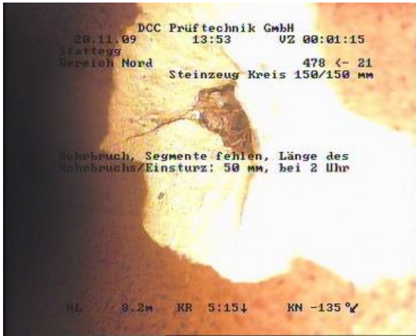
Abbildung 61: Rohrbruch (eigene Untersuchungen Gemeinde Stattegg, 2009)
