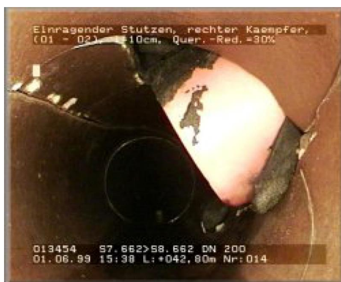
Abbildung 6: Fehlerhaft angeschlossene Zuleitung (Environment Consult in Scaria, 2002)
