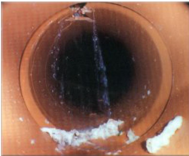
Abbildung 3: Im Grundwasser liegender undichter Kanal (Environment Consult in Scaria, 2002)
