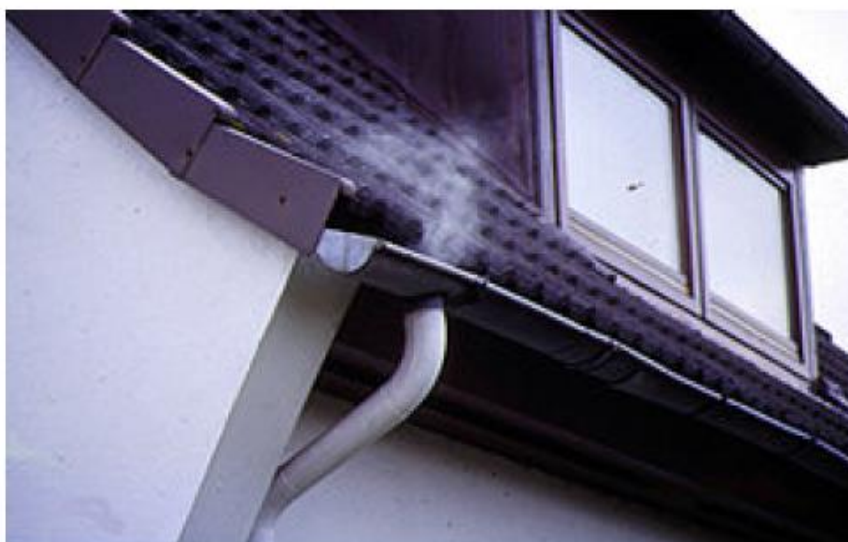
Abbildung 30: Rauchaustritt bei Dacheinläufen (Scaria, 2002)
