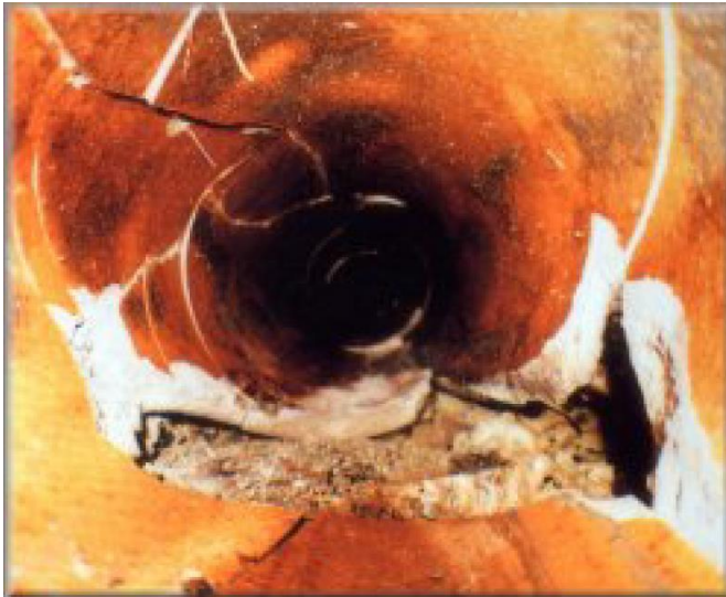
Abbildung 4: Undichtiges Rohr (Environment Consult in Scaria, 2002)
