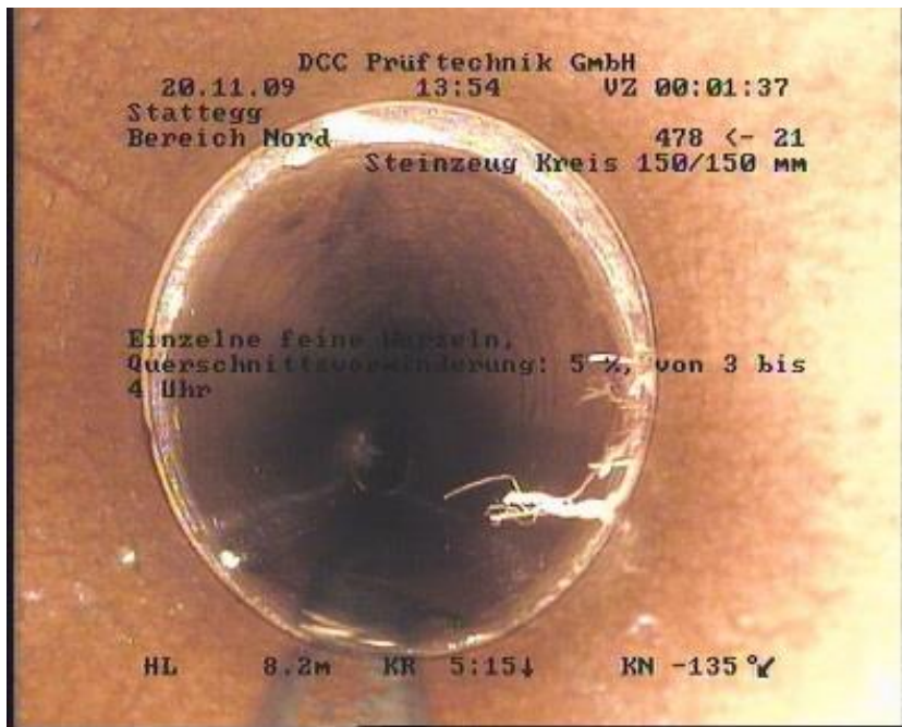
Abbildung 59: Wurzeleinwuchs (eigene Untersuchungen Gemeinde Stattegg, 2009)
