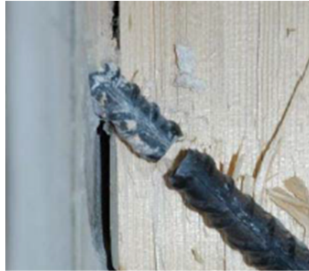
Abbildung 2-12: Versagen der Stahlbewehrung, aus [21]
