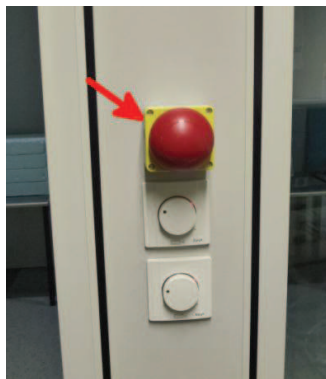
Bild 1: Not-Aus-Taster der Absorberhalle
