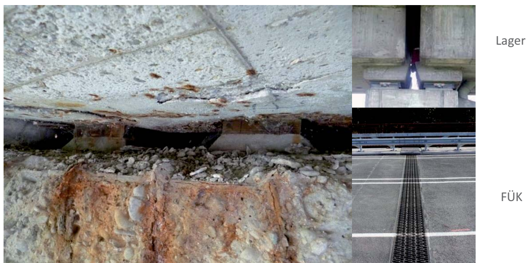
Abbildung 4: Korrosionsangriff am Lager 2
