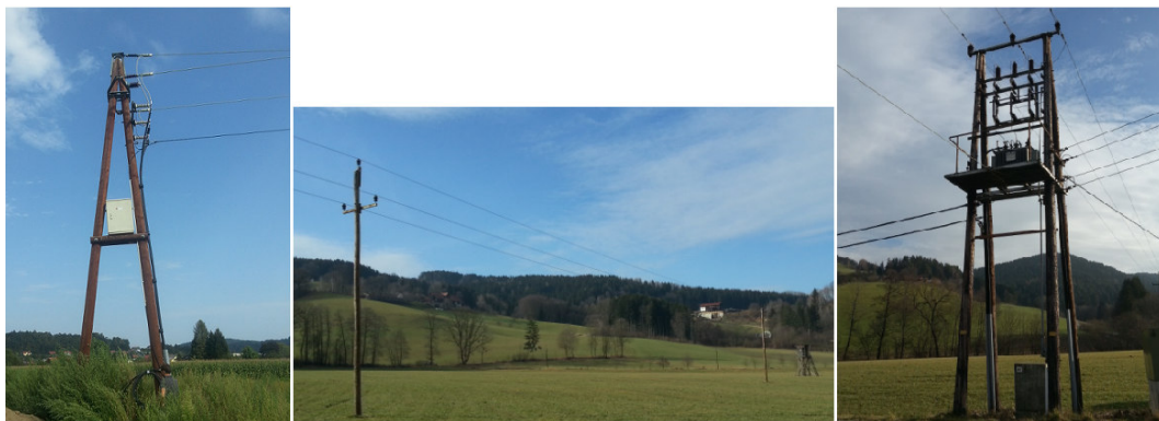
Abbildung 3.14: Links: 10kV Kabelabspannmast; Mitte: 10kV Spannfeld; Rechts: 10kV Abspannmast mit Transformator
