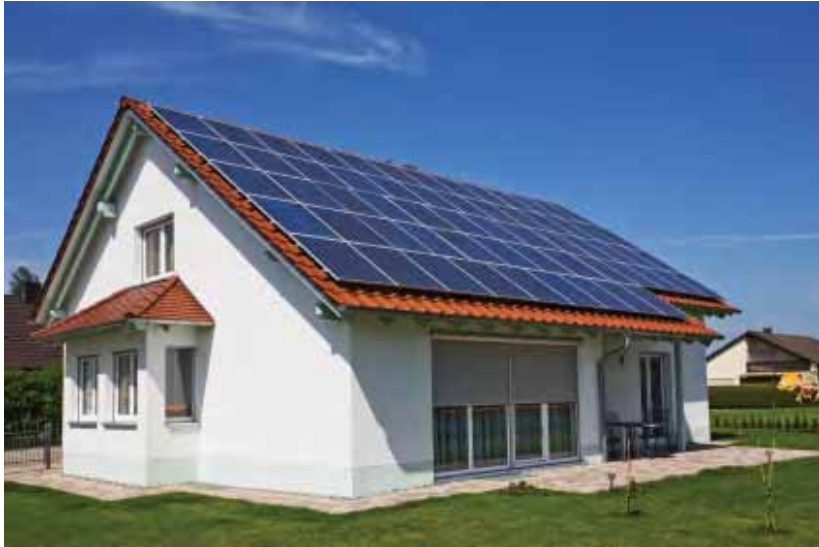
Abbildung 3.25: Photovoltaikanlage als Aufdachanlage ausgeführt 89
