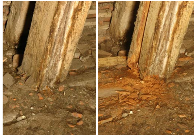
Bild 3. Links: Ansicht vor der Klopfprobe, Rechts: danach. Fig. 3. Left: view before knocking test, Right: afterwards.
