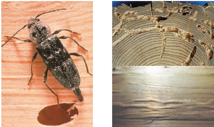
Abb. 3.11: Links: Hausbockkäfer nebst ovalem Ausflugloch; Rechts oben: Fraßgänge der Hausbocklarven; Rechts unten: typischer venenartiger Verlauf der Fraßgänge an der Oberfläche (GRAF (2001 S. 10))
