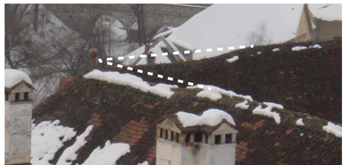
Bild 18. „Abgesoffener“ First im Bereich einer Dachverschneidung (vgl. [2]).
