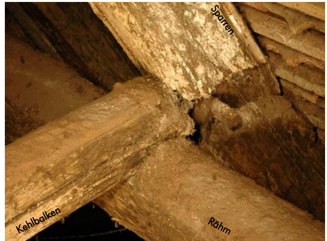
Bild 17. Verschmutzung der Bauhölzer.
