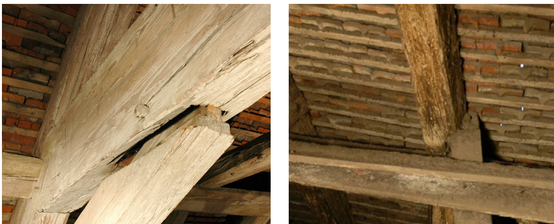
Abb. 4.3: Links: Klaffung an einem Kopfband – Spannriegel Anschluss (Alte Universität, Graz), Rechts: Verdrehung eines Sparren an einem Kehlbalken – Sparrenanschluss (Ferdinandeum, Graz)
