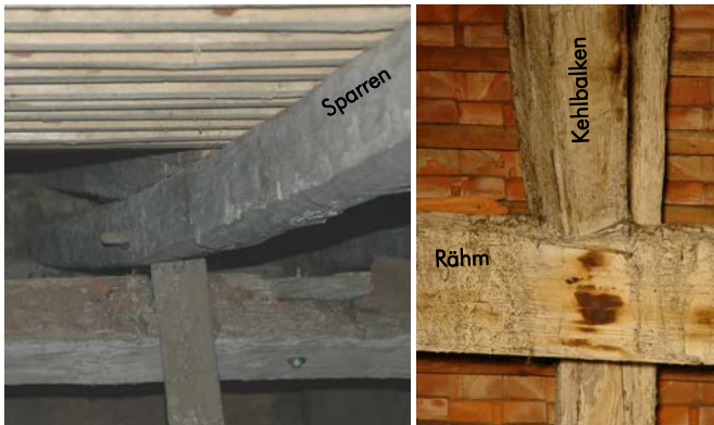
Bild 15. Links: Verformung des Sparrens infolge eines asymmetrischen Stuhls, Rechts: Verdrehung eines Kehlbalkens infolge von Schrägfasrigkeit in Kombination mit Schwindvorgängen.
