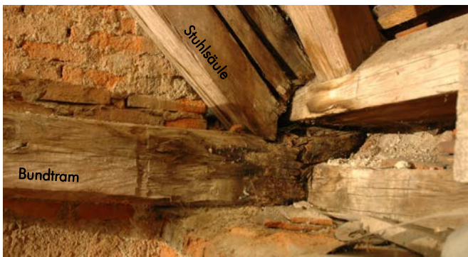
Bild 12. Versagter Stuhlsäulenfußpunkt. Fig. 12. Failure of a frame column base.
