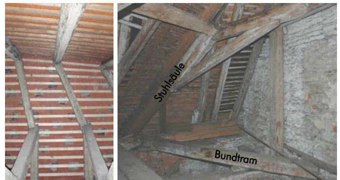
Bild 14. Links: Firstbereich ohne Aussteifung in Firstrichtung, Rechts: Kehlbalkendach mit einfach liegendem Stuhl (mit nicht fachgerechter Instandsetzung).
