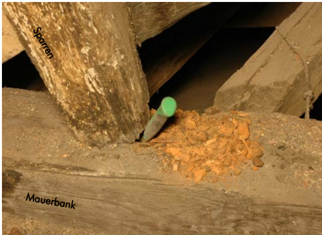
Bild 11. Innenfäule einer Mauerbank. Fig. 11. Internal rot of a bending beam.
