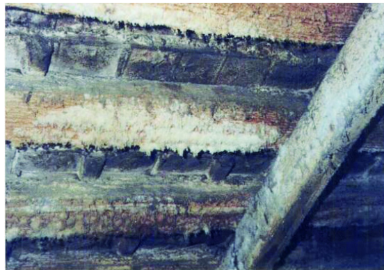
Abb. 3.15: chemische Korrosion an Dachlatten und Sparren (LISSNER ; RUG U. A. (2000 S. 161))
