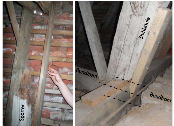
Bild 9. Nicht fachgerechte Instandsetzungen.
