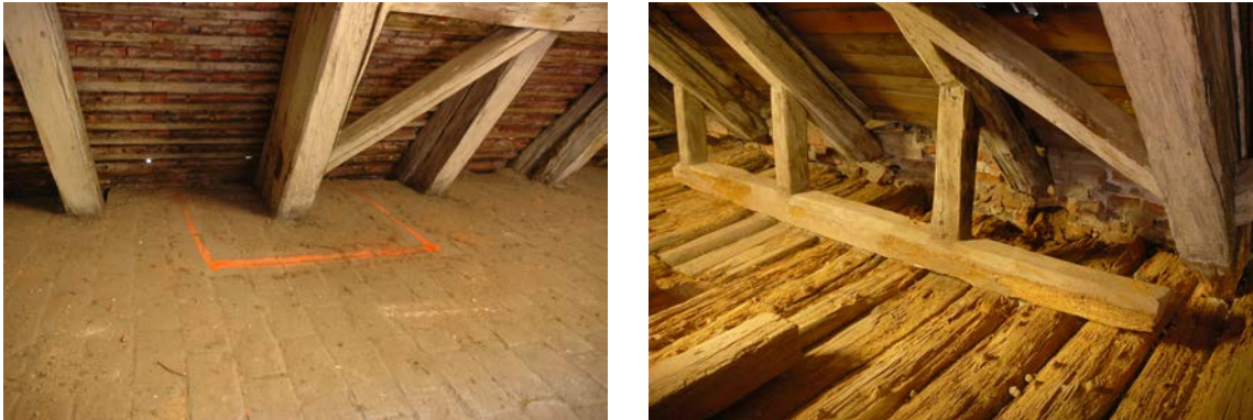
Abb. 3.4: Durch Bodenaufbau verdeckter Schaden an Dippelbaumdecke (Palais Herberstein, Graz)
