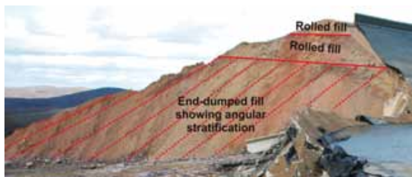
Abbildung 2.9: Dammquerschnitt nach der Zerstörung 33
