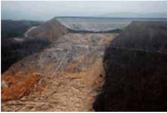
Abbildung 2.10: Ansicht des gebrochenen Damms 34
