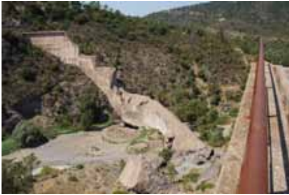
Abbildung 2.4: Ausschnitt der zerstörten Stau- mauer 25
