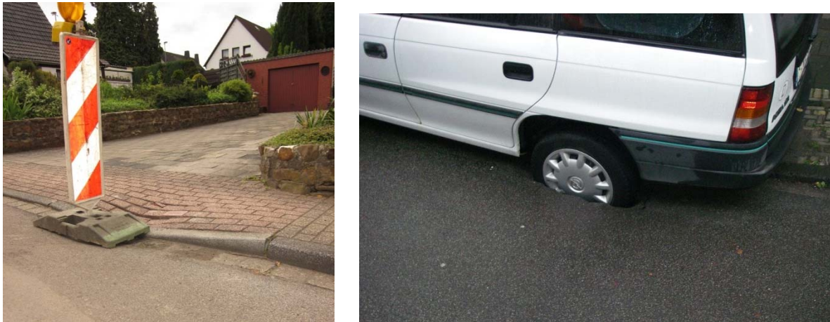
Abbildung 29: Links: Absackung im Gehsteigbereich (Stadt Alsdorf); rechts: Straßeneinbruch (Stadt Hamm)
