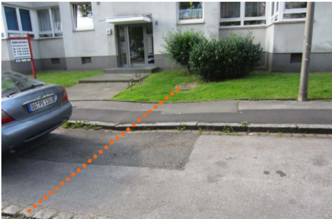
Abbildung 30: Absackungen Straßen-, Gehwegs- und Hofbereich; orange: Verlauf der Anschlussleitung (Stadt Dortmund)
