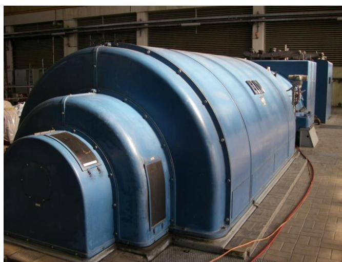
Abbildung 6: Foto von Generator 5, HKW I
