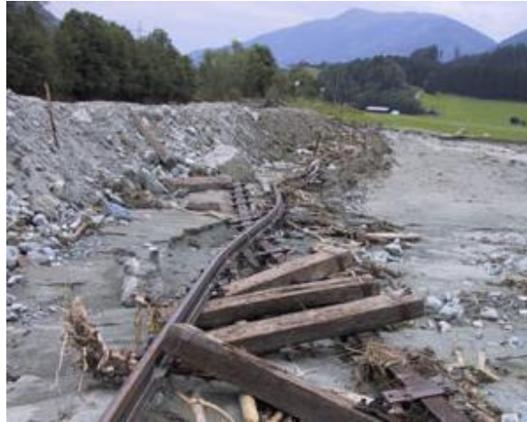
Abbildung 13: Hochwasserschäden auf dem Abschnitt Mittersill – Krimml [40]
