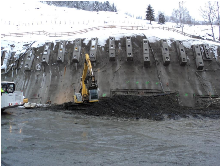
Abbildung 64: Fehlender "Fuß" der Spritzbetonwand nach Aushubschritt [18]
