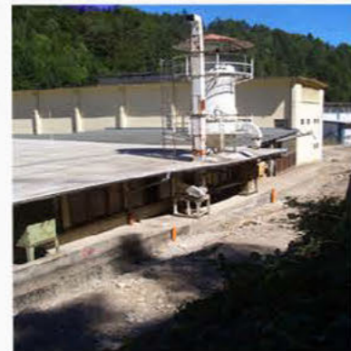
Neuverlegung der Druckrohrleitung (Komplettversiegelung der bestehenden alten Kelag-Druckrohrleitung, die mitten durch das gesamte Areal verläuft)
