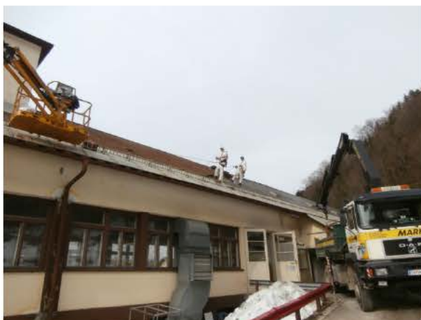
Abb.91: Abdeckung der Asbestziegel
