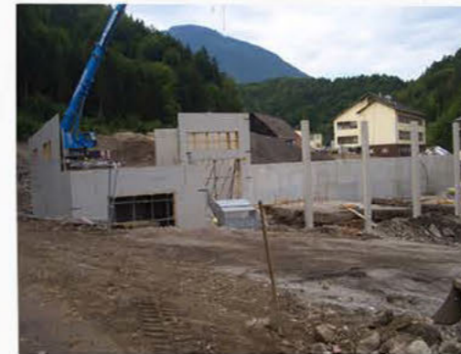
Bau des Biomasseheizkraftwerkes (ca. 1000m 2 ) durch den Betreiber BC-Regionalwärme Köttmannsdorf in Kärnten
