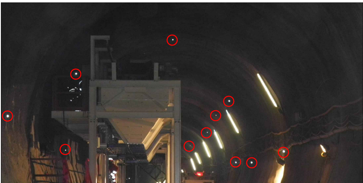
Abbildung 3.16: Multiple Prismen in einem Tunnel (Prismen in Rot hervorgehoben, Foto aufgenommen vom IGMS)
