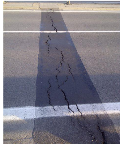
Belagsdehnfuge mit großen Rissen [4]
