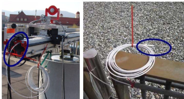
Abbildung 8-5: Befestigung des Temperatursensors (blau markiert) im Träger: (links) Sensor (blau markiert) am Geländer (rechts)
