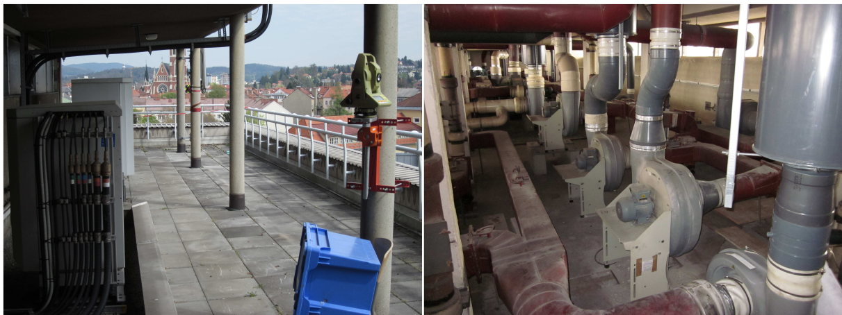
Abbildung 8-9: TCA 1800 auf Säule 4 (links), Lüftungsmotoren im Raum dahinter (rechts)
