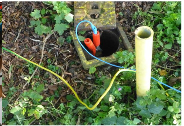
Abbildung 6-13 Übergangswiderstand Feuerschieber (FS)
