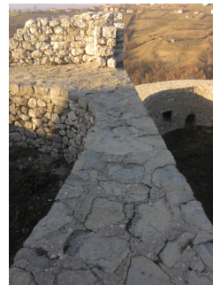
Abb. 43: Mauer am Turm III im Jänner 2014
