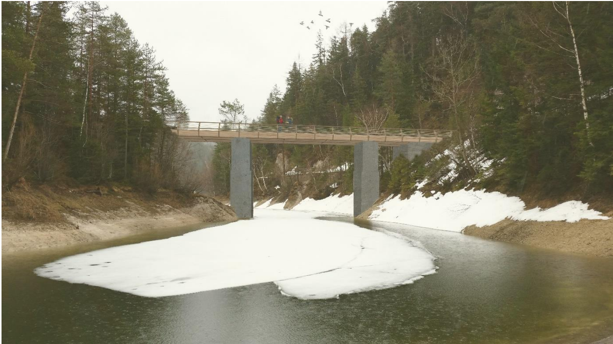
Abbildung 78: Ansicht seitlich in Fließrichtung.
