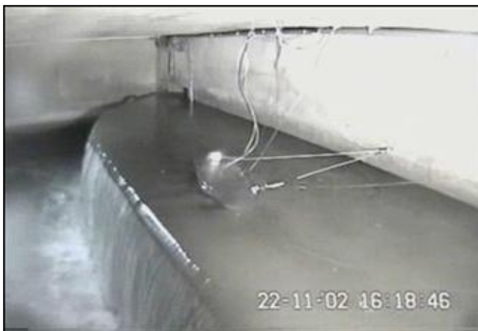
Abbildung 2-14: Ponton in der Mischwasserüberlaufkammer (Gruber et al. , 2004)
