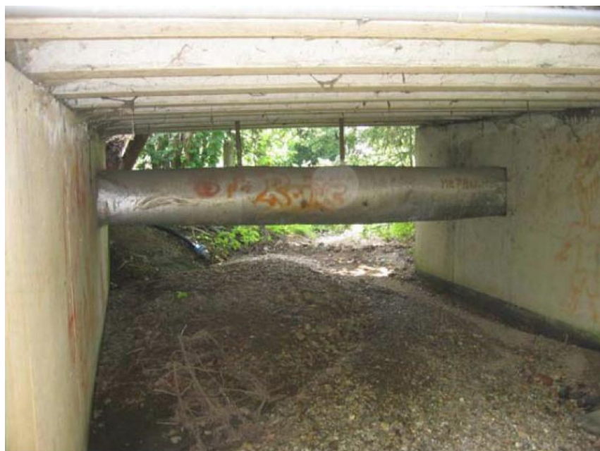
Abb. 53: Rohrleitung und Geschiebeanlandung im Abflussquerschnitt unter einer Brücke [76]
