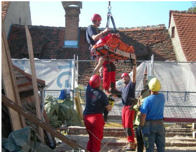
Abb. 9: Einsatz der Höhenrettung der BF Graz nach einem Bauunfall [6]
