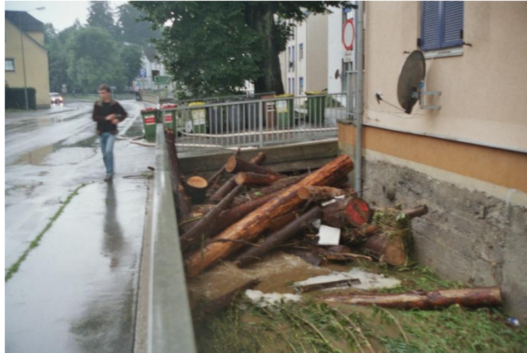
Abb. 51: Massive Verklauung eines Straßendurchlasses [26]
