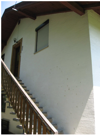
(a) Verputzabsplitterungen zufolge eines Hagelschlages
