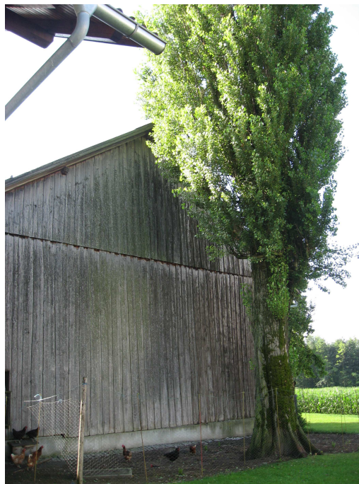
Abbildung 36: Im Falle einer Entwurzelung des Baumes könnte es zu einer Fundamentzerstörung führen
