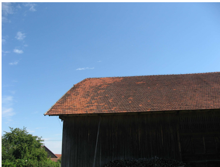
Abbildung 33: Typische Windschäden an Tonziegeldächern infolge mangelhafter Verankerung der Ziegel
