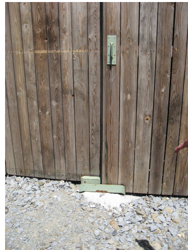
(b) Zusätzliche Bodenhalterung der seitlichen Tore eines Vierseithofes verhindern das Aufreißen der Tore und somit weitere schwere Folgeschäden
