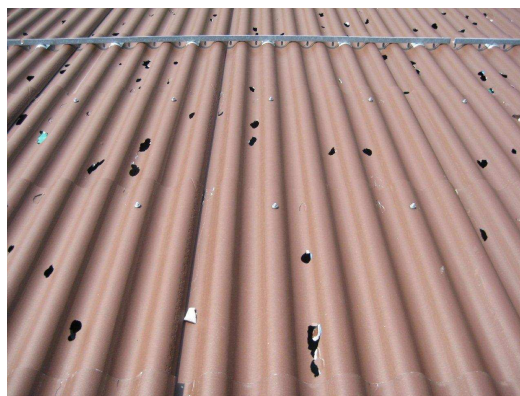
(b) Vollständige Zerstörung einer Welleterniteindeckung durch Hagel TORRO 5
