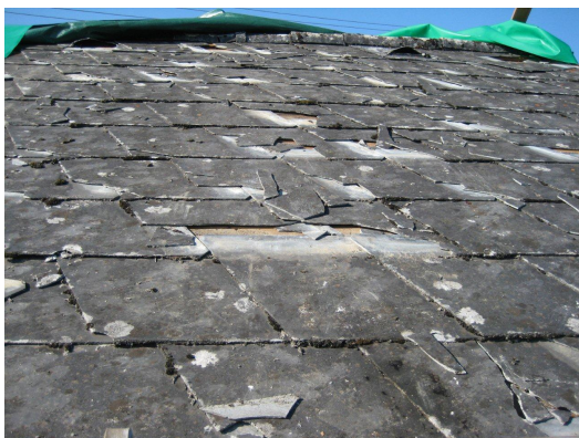
(a) Vollständige Zerstörung einer Platteneterniteindeckung durch Hagel TORRO 5
