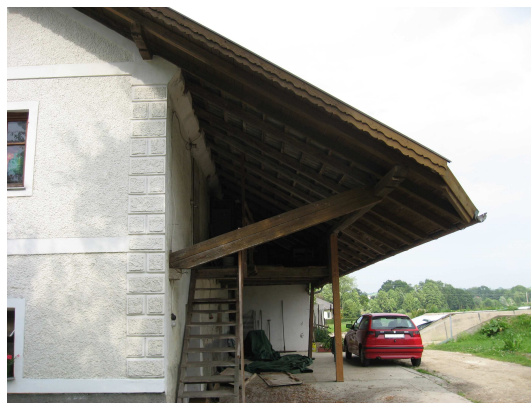
Abbildung 32: Konstruktiv bedingte Staudruckzone, Dachvorsprung nicht verschalt
