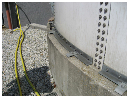
Abbildung 30: In Bezug auf mögliche Windbelastung schwache Verankerungen des Hochsilos - oftmals PVC mit geringem Eigengewicht, erhöht das Risiko
