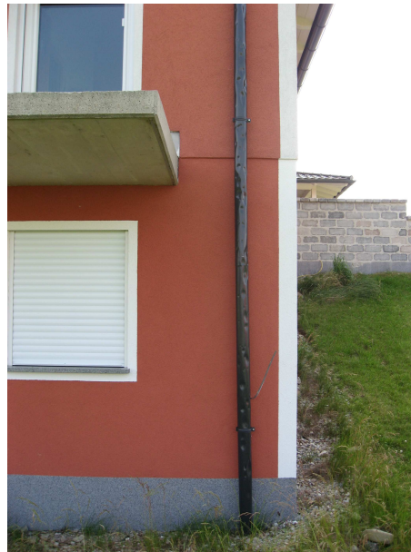
(b) Zerstörungskraft durch Hagel in Verbindung mit Wind an der Dachrinne sichtbar. Anm.: Wärmedämmverbundfassade bereits erneuert
