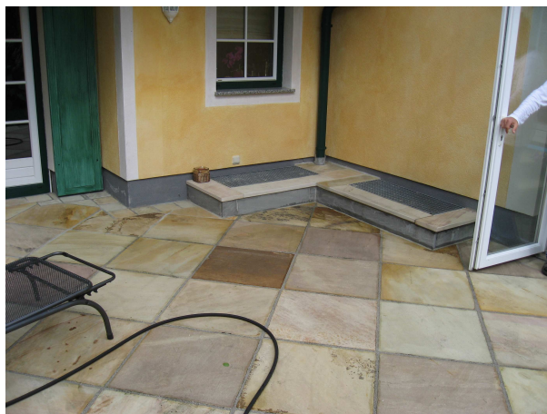
Abbildung 40: Wassereintrittsstelle mit einer Erhöhung der Lichtschächte nach Schaden. Vor dem Schaden gab es diese Erhöhung der Lichtschächte nicht.
