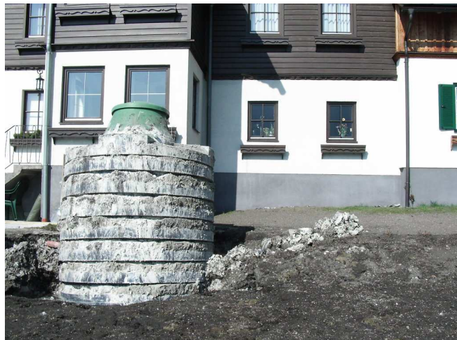
(b) Pelletstank wie in Abbildung 42a im folgenden Frühjahr nach Anstieg des Grundwasserspiegels
